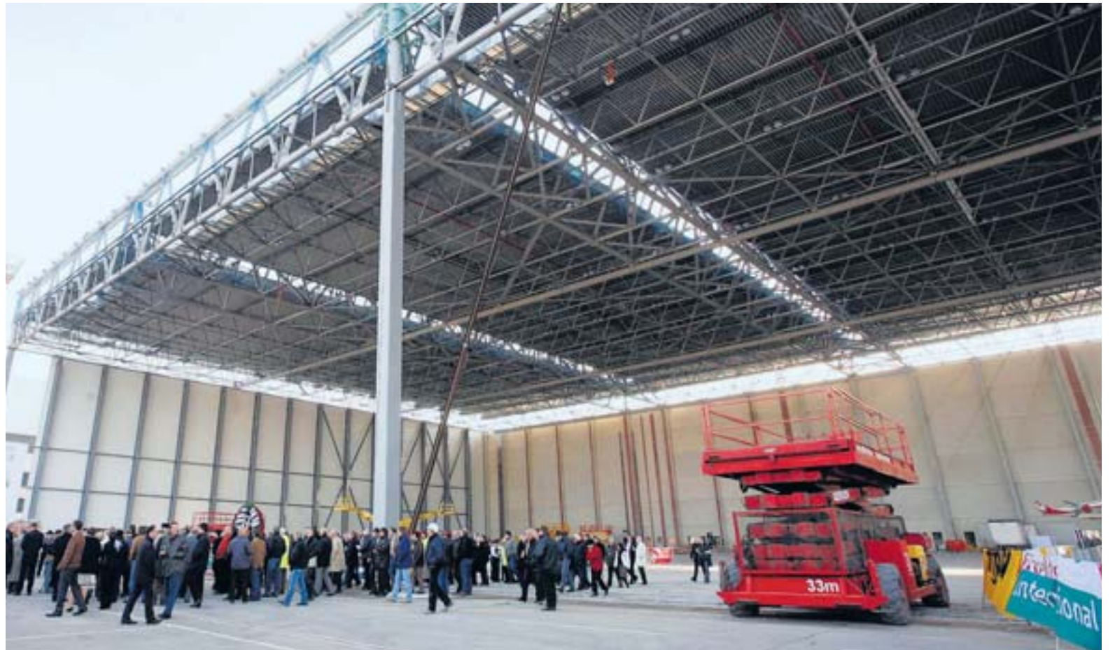
Die Ausmaße der neuen Wartungshalle 7 am Flughafen sind enorm. Noch fehlen zwei Wände, bevor die insgesamt 37 000 Quadratmeter ihrer Bestimmung übergeben werden können. RP-FOTOS (2): ACHIM HÜSKES
